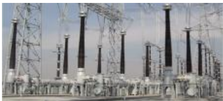
图 1 南阳站 100 kV HGIS 设备
